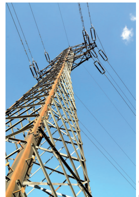
Fig 4.69 Las estructuras eléctricas por lo general son trianguladas.
